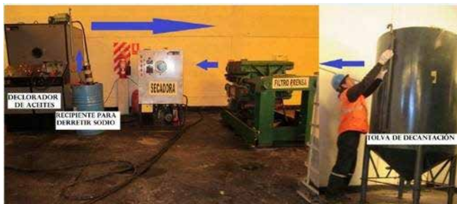
Figura 5. Proceso del tratamiento por dechlorinación y regeneración de PCBs, Inicia desde el equipo dechlorinador, pasa a las tolvas de decantación, secadora, filtro de prensa y rellenado del aceite.
